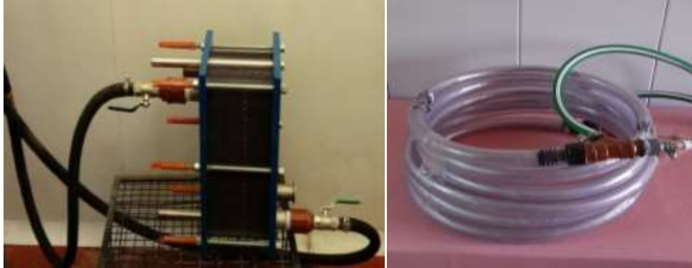
Figura N°1.10: Enfriador de placas y contracorriente
