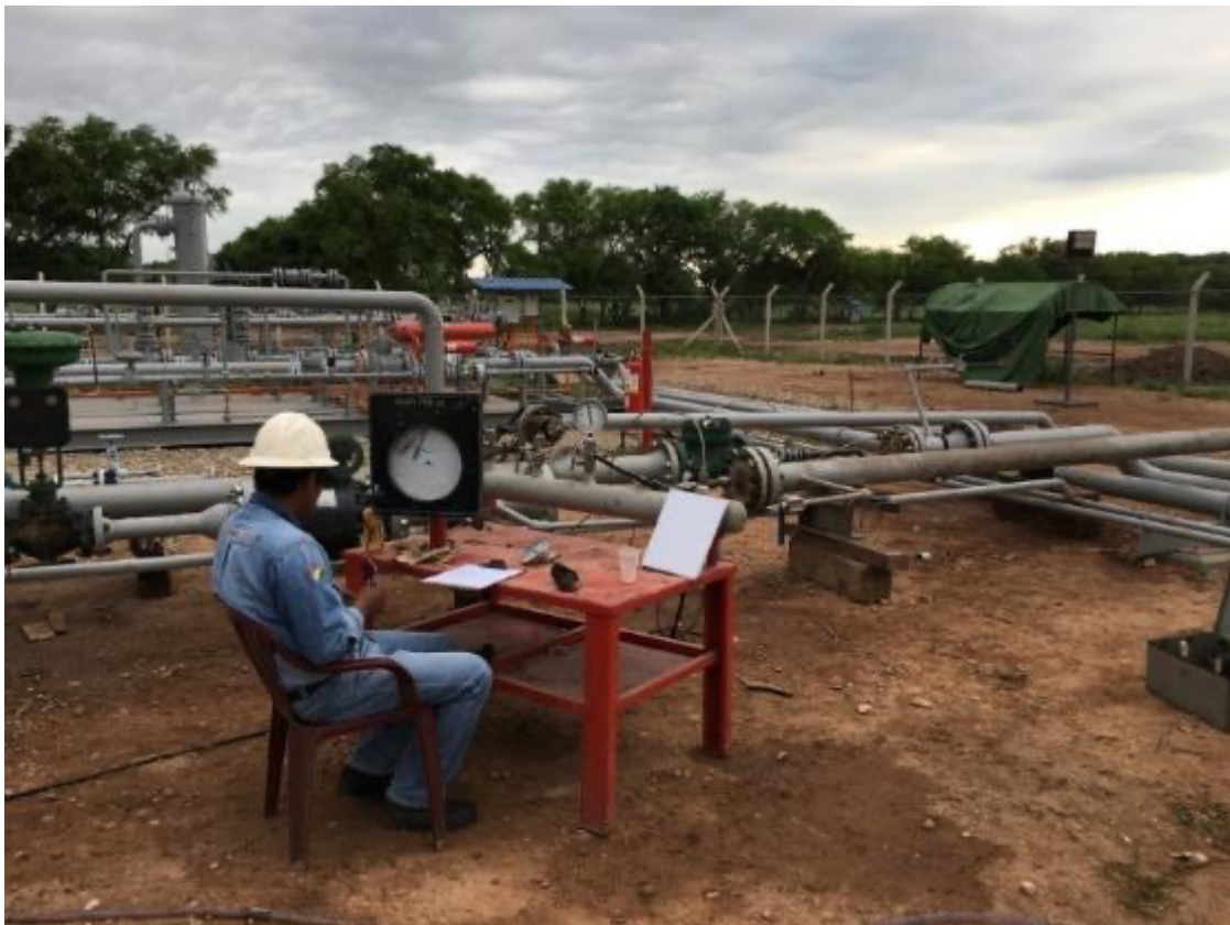
Imagen 3: Prueba hidráulica, en la que se comprueba la integridad del ducto, mediante la presión del agua lanzada. Data Book línea Boycobo 2015.
