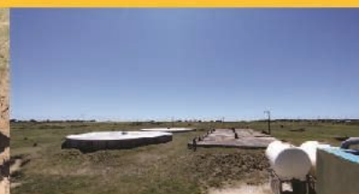
FIG 2. CISTERNAS Y PLANTA DE POTABILIZACIÓN. COS
