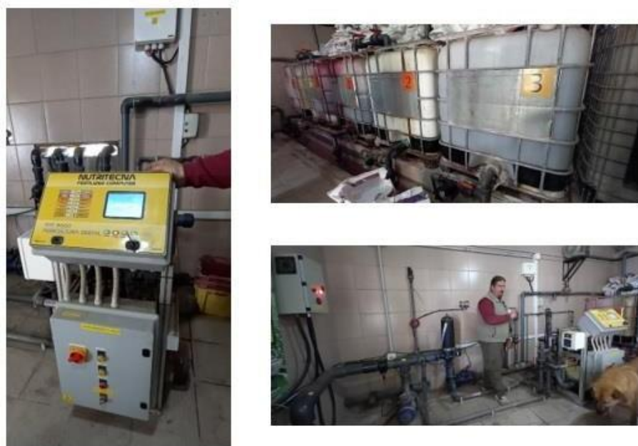
Figura 19: Equipo de Fertirriego Automático + Tanques de solución madre, Finca el Sauce. Fuente: Elaboración propia
