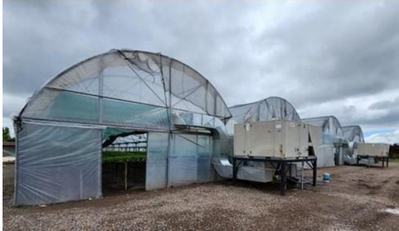
Figura 29: Invernadero con sistema de generadores frío/calor.
