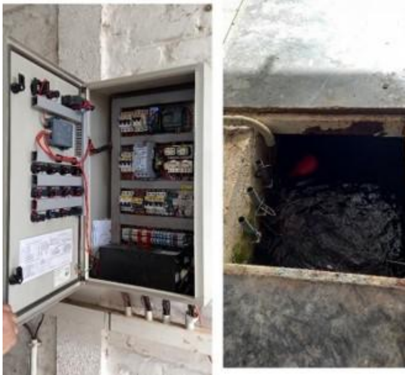
Figura 17: Tablero eléctrico del equipo de bombeo (Izquierda). Cisterna y sondas de pH, CE y temperatura (derecha). Fuente: Elaboración propia.
