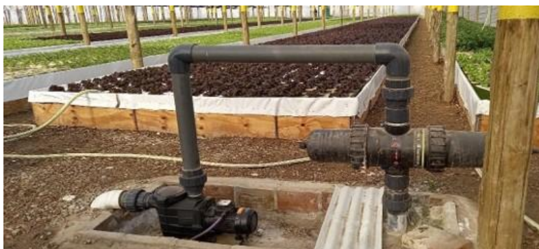
Figura 14: Cabezal de riego (bomba doble turbina de 3 HP y filtro de malla. Fuente: Elaboración propia.
