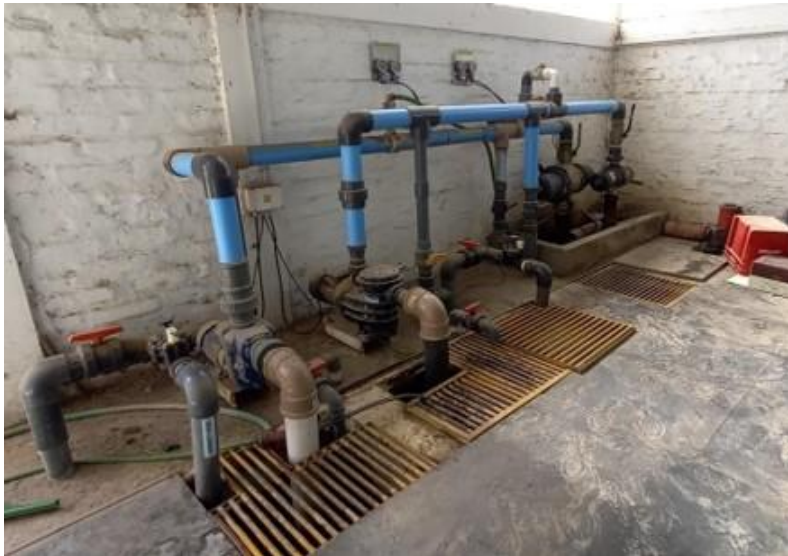
Figura 18: Cabezal de riego (bombas + cisterna con solución madre), Fuente: Elaboración propia.
