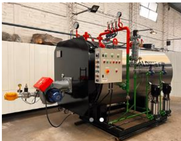
Figura 15 Caldera de vapor [47]
