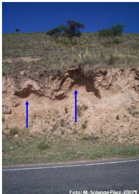
Imagen 6. Talud con pérdida de material en la parte superior
